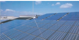
● テクノコンプレックスに設置した太陽光発電システム
