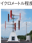
▲ 学内に設置した垂直軸風車発電設備
