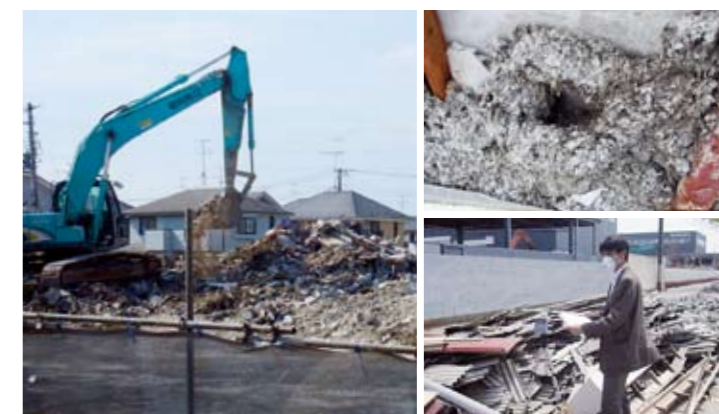
左/粉じんの飛散防止対策が取られないまま、がれきの破碎処理が行われる現場の大気中からアスベストを検出(5月7日 宮城県東松島市) 右上/大量のアスベストが含まれていると考えられる吹き付け材 右下/アスベストが含まれるとみられる建材付近の大気を調査(5月7日 宮城県多賀城市)
