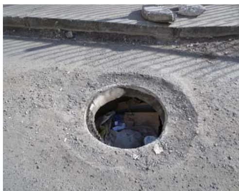
蓋のないマンホール（至るところにある）
