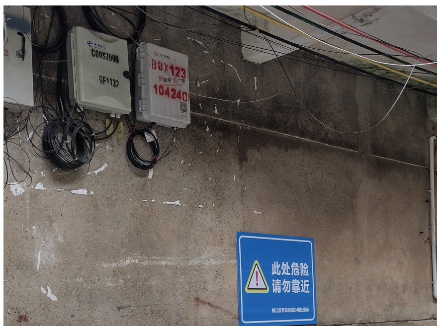
図9 危険建物に指定されている建物。電気装置があることからこの建物も最近まで、現役として使用されていたのかもしれない。
