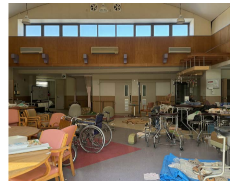
避難指示区域内の高齢者施設の被害
