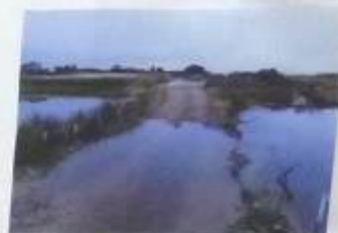
福島県双葉郡広野町 海沿いの道路は津波によって 完全にアスファルトが流され、 冠水していた。
