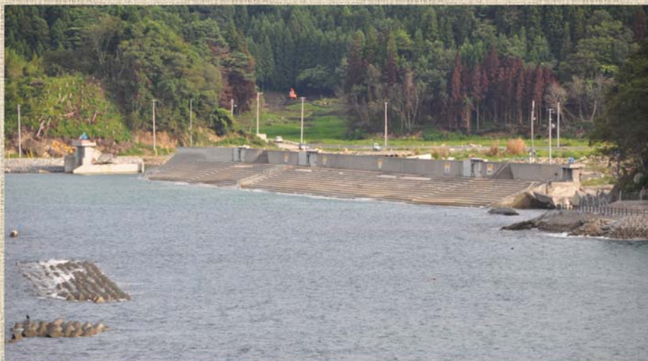
田谷海岸の破壊された堤防の全景。堤防の前には毎年海水浴客で賑わう砂浜があった。左上にこの写真に対応するGoogle Map。右上の地図中黄色い領域がこの一帯である。
