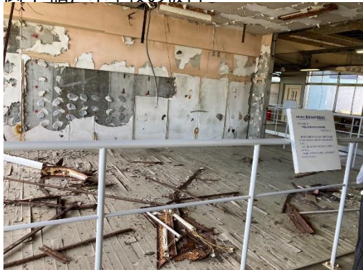
図1 請戸小学校の被害
