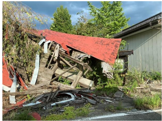
図 5 倒壊した家屋
