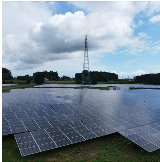
一帯に敷き詰められたソーラーパネル。
