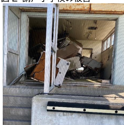
図2 請戸小学校の被害
