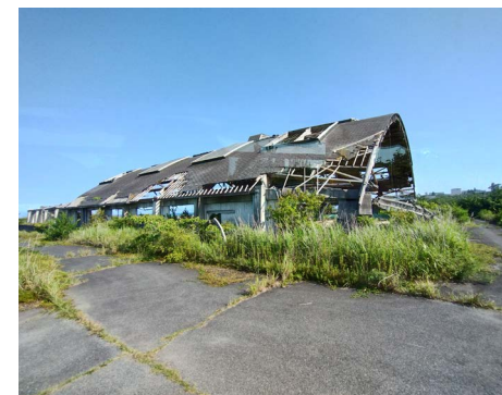
津波被害の建物
