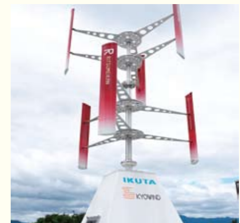
研究棟屋上に設置された風力発電機。垂直の羽根が全方位の風をつかまえ、弱風でも効率よく発電できる。
