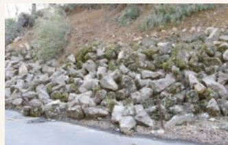
仙台北城跡本丸北西部の市道仙台北城跡線に沿う石垣の崩壊状況（E面の石垣） 青葉城資料展示館主任学芸員・大沢氏撮影
