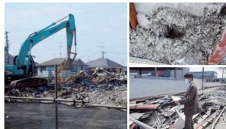
左／粉じんの飛散防止対策が取られないまま、がれきの破砕処理が行われる現場の大気中からアスベストを検出（5月7日 宮城県東松島市） 右上／大量のアスベストが含まれていると考えられる吹き付け材 右下／アスベストが含まれるとみられる建材付近の大気を調査（5月7日 宮城県多賀城市）
