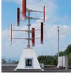
▲学内に設置した垂直軸風車発電設備
