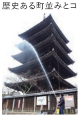
▲自然水源を活用した市民消火栓：清水寺周辺地域に整備された一人て操作できる初期消火ネットワークシステム
